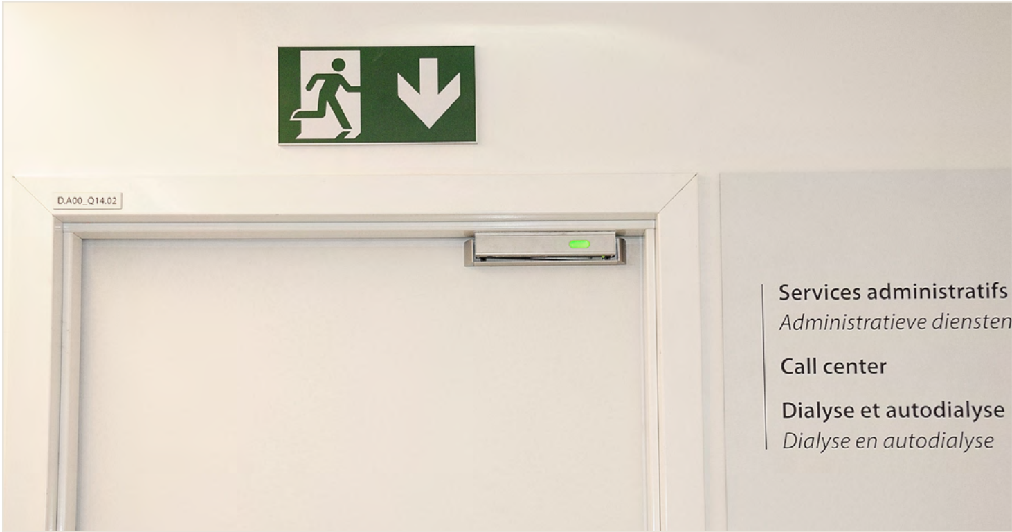
Installation d'un Vortex, VX2400LP, dans un centre hospitalier
